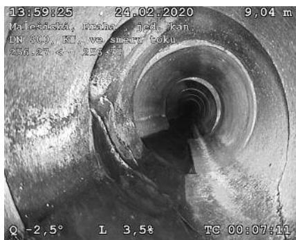
Obr. 6a: Popraskaná odbočná kameninová tvarovka před opravou.
