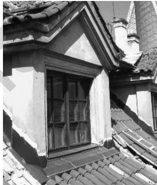
Obr. 8: Vlevo: Oplechování u kamenné atiky bez zapuštění do drážky.
