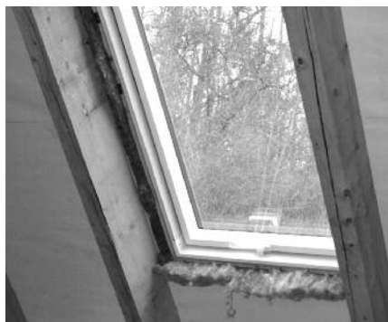
Obr. 8: Detail trhliny na nevhodně dimenzovaných krokvicích v místě osazení střešního okna.
