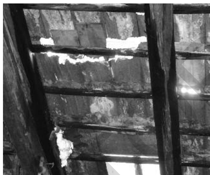
Obr. 9: Nevhodné provizorní řešení poruch střešního pláště.
