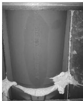
Obr. 5: Stopy vlhkosti na rubu prejzové krytiny po dešti před „zatažením“ střepeu.
