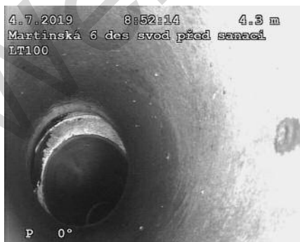
Obr. 7a: Netěsný spoj trub posunutý v úhlu před opravou.
