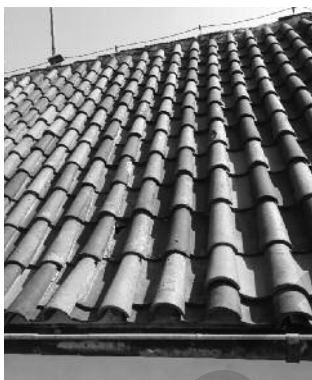
Obr. 3: Vlevo: Posunutá a poškozená prejzy (Hlavní nádraží v Praze).
