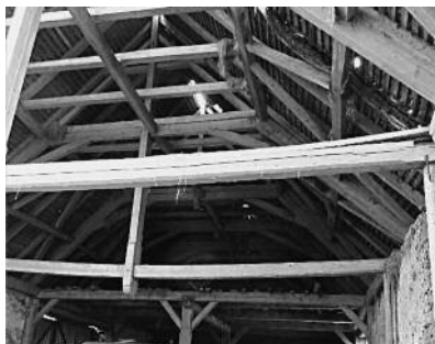
Obr. 8: Řada konstrukcí v krovu, kde je problém, může mít zdeformovaný tvar, a to buď průhybem, natočením, výskytem trhlin. Zdravá konstrukce (např. trámy v podlaže) by měla lehce pružit při došlapu. Je vhodné také prověřit detaily tesařských spojů, např. zda nejsou posunuty, natočeny či nepraskají.
