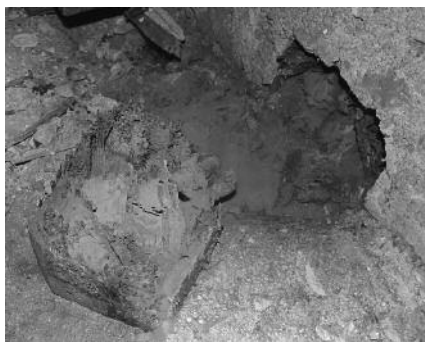
Obr. 2: Destrukce dřeva – stropního trámu v zazděné kapse a jeho rozpad po symbiotickém působení houby hnědé hniloby a dřevokazného hmyzu (červotoče umrlčího).
