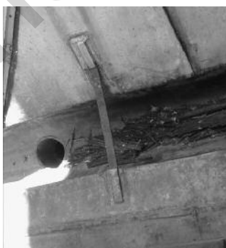
Obr 7a, b: Praha, Strakova akademie. Vlevo: Prasklé pájené spojky oplechování zaatikových žlabů. Vpravo: Destrukce pochozích lávek zaatikových žlabů.
