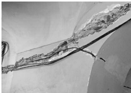
Obr. 12: Při provádění stavebních úprav je třeba dohlížet na to, zda nejsou prováděny stavební zásahy ohrožující statiku kleneb, klenebních pasů apod. Je třeba zejména kontrolovat trasování inženýrských sítí, a to jak ve výkresech, tak vlastní provádění na stavbě.
