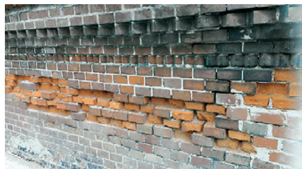
Obr. 1: Porušení režného cihelného zdiva krystalizací solí.
