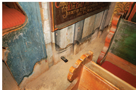
Obr. 10: Juhovýchodná časť interiéru kostola s vyznačením miesta meraní vlhkosti dreveného obkladu zrubovej steny západne od tzv. Zmeškalovskej lavice, zavlhnutie spôsobené vodou z exteriéru.
