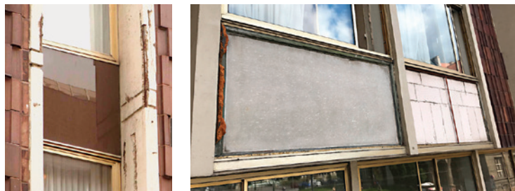
Obr. 12a, b: Lehký obvodový plášť. Vpravo izolační desky z azbestových vláken v jádru sendviče obnažené po opadání skleněných desek.
