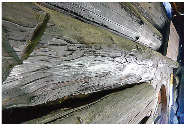
Obr. 12: Degradovaná machová výplň škár zrubovej konštrukcie pri východnom nároží krytá strechou vstupného schodiska.
