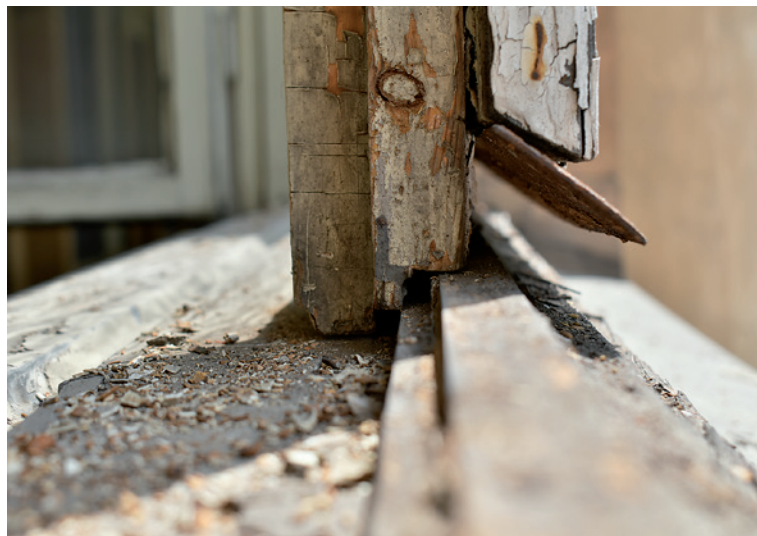
Obr. 1: Nejčastější příčinou výměny oken je zvýšená průvzdušnost. Přesto i po století provozu je možná oprava nalehávky.
