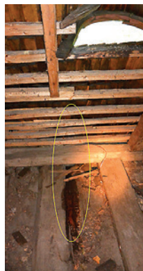
Obr. 8: Poškodenia spôsobené zatekajúcim vikierom.
