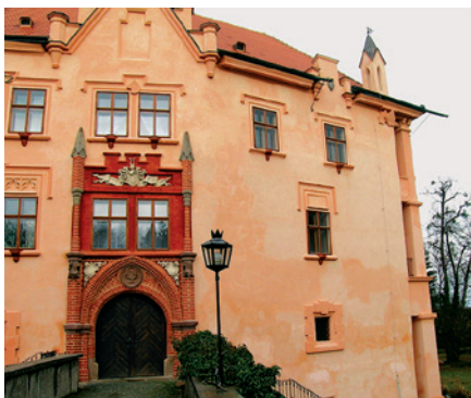
Obr. 6: Zámek Vrchotovy Janovice – plochy s hygroskopickou vlhkostí na vstupním průčelí.
