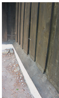
Obr. 5: Západné nárožie kostola s výrazným zavlnutím drevených prvkov v kontakte s podmurovkou. Opláštenie zruba je tu realizované zo šikmo hranených dosiek osadených na zraz. Vodorovne spodné krycie dosky sú v spodnej časti prekryté mazaninou a tak nezabezpečujú dostatočnú ochranu proti vlhkosti (atmosférickej, vzlianjúcej z podmurovky).
