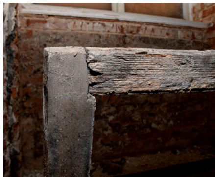
Obr. 2: Vodorovná část je původní svislý vlys, svislá je nově vložený spodní vlys rámu. Oprava provedena patrně před rokem 1930.
