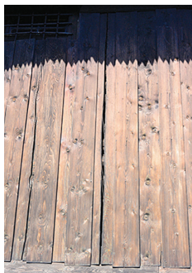
Obr. 11: Dřeskové prekladané opláštenie fasády s výraznými pozdĺžnymi prasklinami na viacerých doskách.
