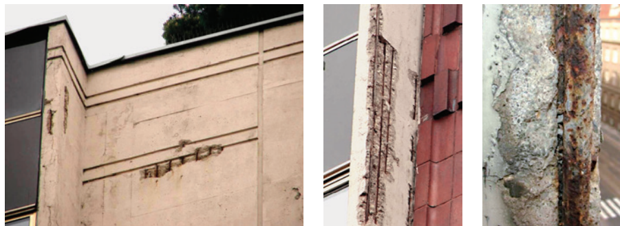
Obr. 5a–c: Poruchy monolitu, prefa panelů („žiletek“). Zcela vpravo detail silné koroze výztuže s tvorbou korozních zplodin a oslabením průřezu (žebírková výztuž).
