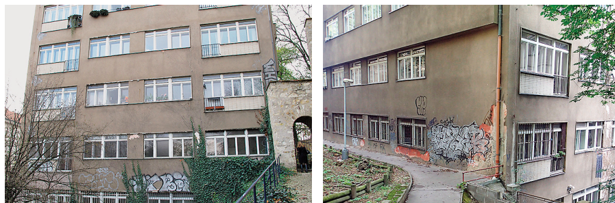
Obr. 4a, b: Současný stav fasády: a – severní průčelí, b – západní a jižní průčelí. (Foto R. Gill) [3]
