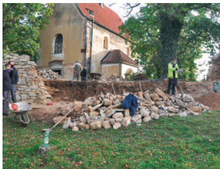
Obr. 12: Vybouraná část kavernou, trhlinami narušené a vykloněné zdi.
