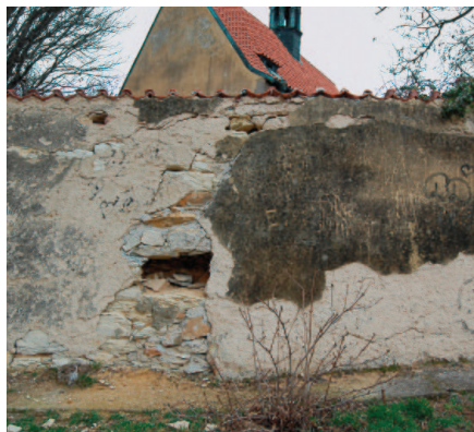
Obr. 8: Vyklonění zdi a porušení rozpadem a vydrolením kamene – kaverna na jižní straně ohradní zdi.
