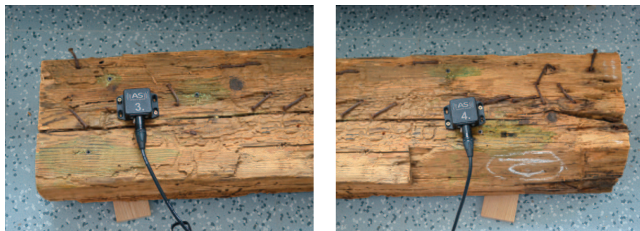
Obr. 4b: Akustická detekce aktivity larev hmyzu systémem Acoustic Pack – trám č. 4 (Thermo Sanace s.r.o.).
