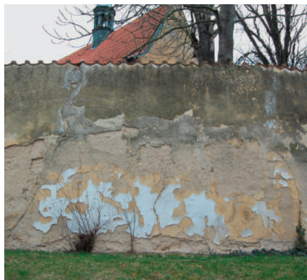
Obr. 9: Rozpad omítky v ploše s pronikající zemní vlhkostí, dilatační trhlina na SZ straně.
