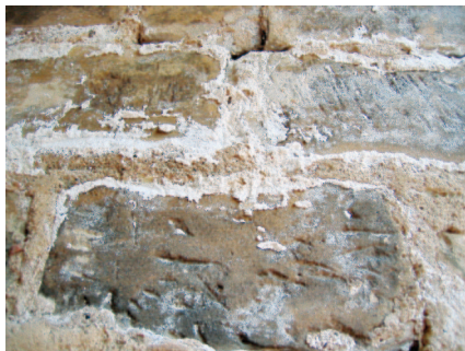
Obr. 5: Efflorescence na kamenném zdivu. Laudonův pavilon, zámek Veltrusy. Zjištěná směs solí ve výkvětu: trona, monohydrát uhličitaneu sodného, aphthitalit, burkeit, thenardit.
