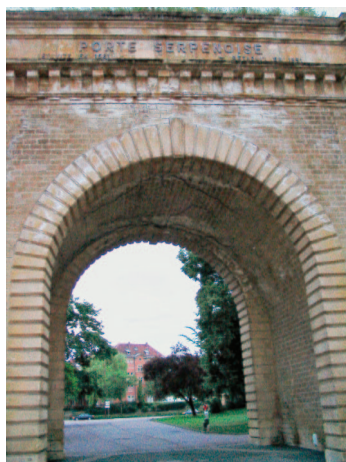
Obr. 4: Efflorescence (výkvěty) solí na povrchu zdiva mostu. Mety, Francie.
