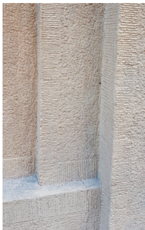
Obr. 12: Umělý kámen opatřený nátěrem.
