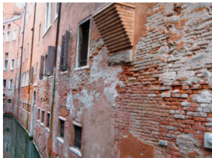
Obr. 3: Poškození povrchové vrstvy cihelného zdiva solemi proniklými do zdiva se vztlínající vodou obsahující ionty. Benátky, Itálie.
