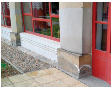
Obr. 2: Poškození povrchu omítky na soklu a výkvěty na povrchu kamene (Lázně Mšené).
