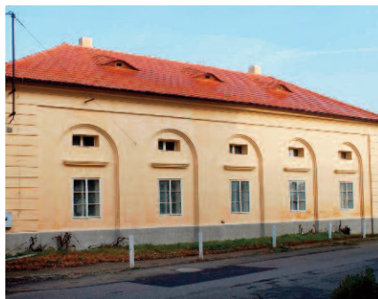
Obr. 2: Poruchy povrchů byly zřejmě již bezprostředně po skončení stavebních prací. (Archiv správy zámku)
