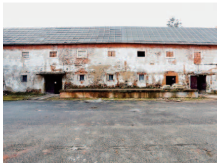
Obr. 6: Stav objektu D před obnovou. (Foto P. Kodera)
