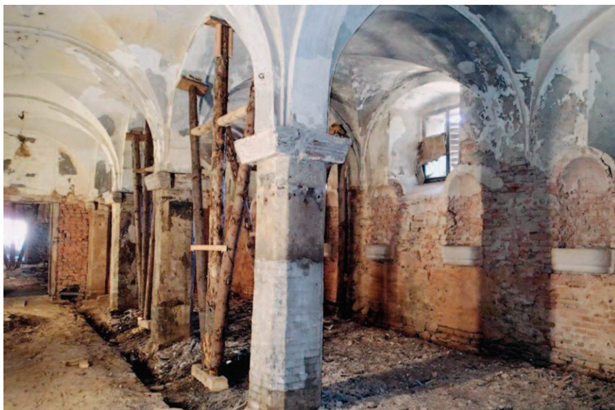
Obr. 6: Zámek Žehušice, konírna. Uvolňování látek amoniakálního charakteru do interiéru je obvyklé v budovách, jež byly v minulosti využívány pro hospodářské účely. (Foto R. Gill, r. 2012)
