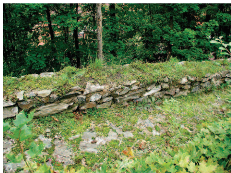
Obr. 6: Část zdiva krytého uměle vysazenou zelení (experiment společnosti STOP na hradě Křivoklát).
