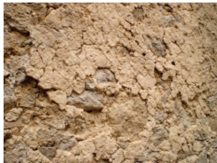
Obr. 4: Zbytky interiérových omítek – detail.
