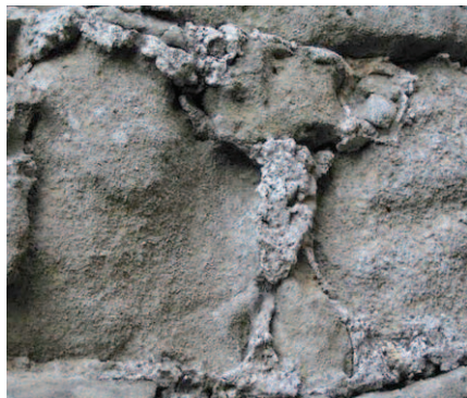
Obr. 5: Degradace kamenného zdiva po spárování cementovou maltou.
