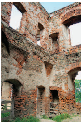
Obr. 4, 5. Vnitřní část paláce, 06/2016 [2]. Vlevo: Na místech chráněných zbytky kleneb zachováno torzo původních omítek. Vpravo: Výrazná koroze zdiva v okolí záchodové šachty.
