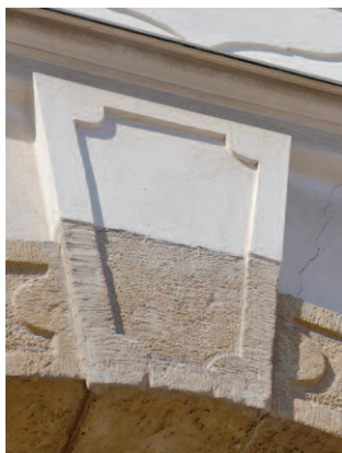
Obr. 5a, b: Obnažení konstrukčního materiálu znehodnocuje architektonické tvarosloví. Hradec Králové, Malé náměstí čp. 111/4 – celek portálu a detail. (Foto autor)
