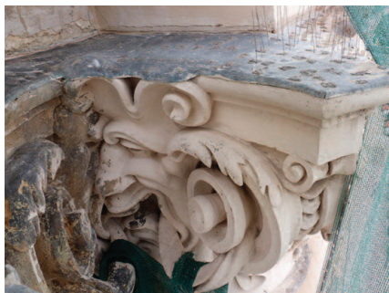
Obr. 9: Praha – Černínský palác, krytí hlavice fasádních polosloupů, měděný plech, 80. léta.
