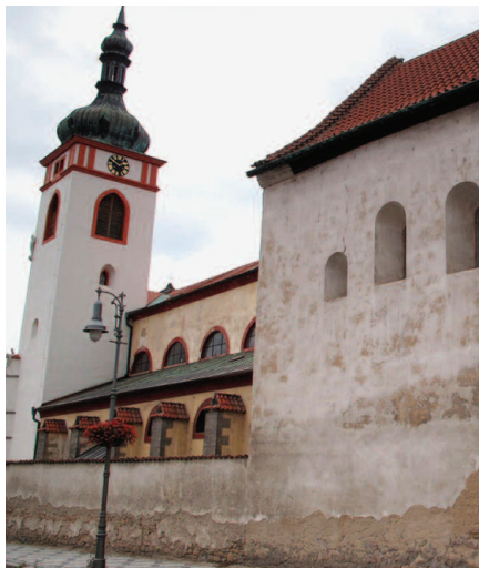
Obr. 4: Rozsáhlé vlhkostní mapy souvisejí též se zasolením povrchů. Chloridy pocházejí ze solení komunikací, dusičnany z organického rozkladu – za zdi je funkční hřbitov.
