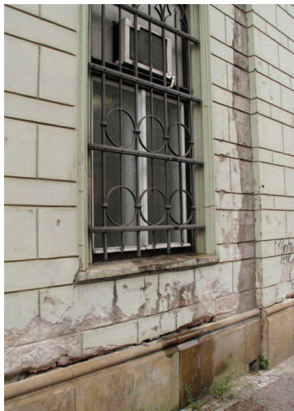
Obr. 6: Omítky zavlhčované v minulosti dešťovým svodem (v drážce zdiva) poškozuje odkapávající klimatizace. Neúspěšné řešení vlhkosti zdiva odsazením soklu.
