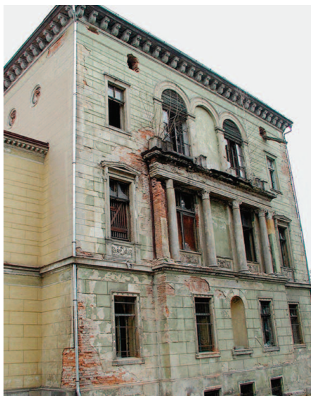
Obr. 1: Při absenci údržby dokáže srážková voda venkovní omítky prakticky zničit.
