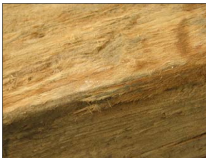
Obr. 1 Rozvlákněný povrch konstrukčního prvku
