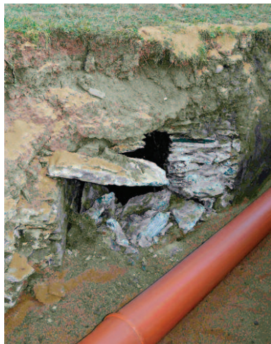
Obr. 4: Původní odvodňovací kanál přerušeny trasou nové kanalizace.
