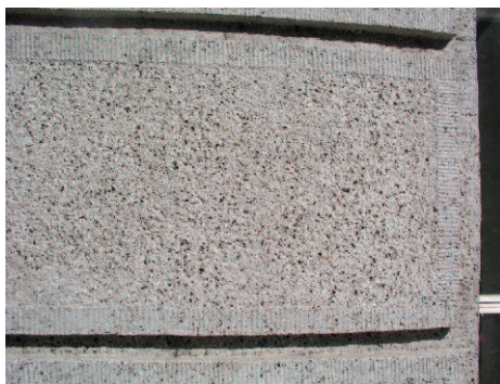
Obr. 2 a, b: Pohledové omítky jsou opticky živější než nátěr.
