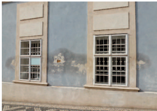
Obr. 14: Praha, Lichtenštejnský palác. Výsledek nedůsledné opravy omítek, kdy nebylo dovoleno nahradit větší rozsah omítky za novou (nikoli sanační) a nepodařilo se ani odsolení.
