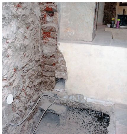
Obr. 2: Zbytek vnitřního ŽB kanálu z rekonstrukce v 90. letech.
