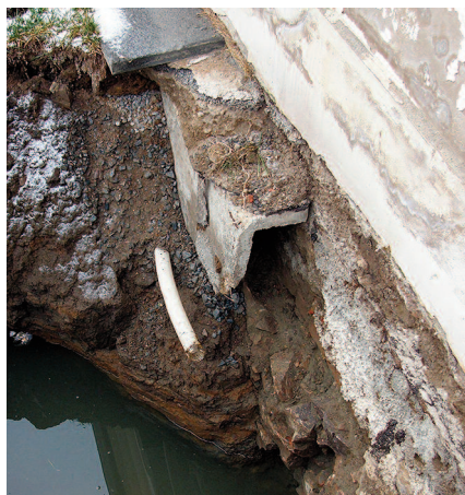
Obr. 3: Při vysokém vlhkovém zatížení zdiva nemají venkovní větrací kanály požadovaný účinek.
