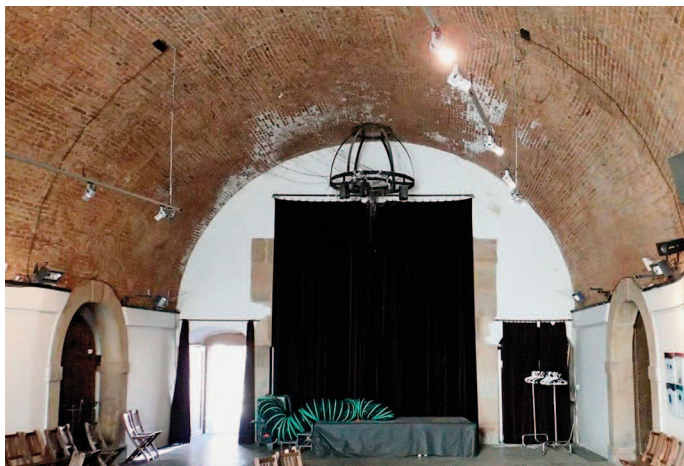
Obr. 4: Voda zatékající do klenby průjezdu vynášela na povrch rozpustné soli – r. 2014, stav před zahájením opravy.
