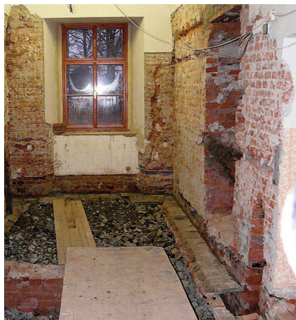
Obr. 4: Podlahový větrací kanál po obvodu místnosti – nádech je pod oknem, odtah do původního komína na pravé straně.
